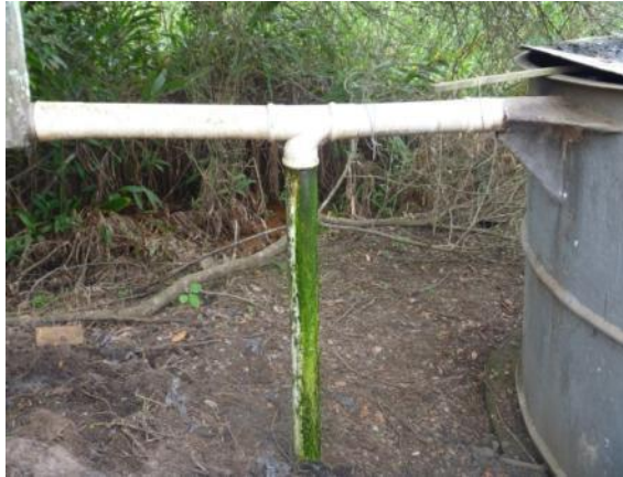
Figura 1.42 – Encanamento com vazamento
