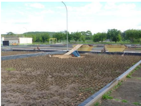
Figura 1.10 – Leitos de secagem
