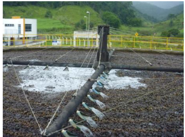
Figura 1.18 – Filtro biológico percolador em funcionamento
