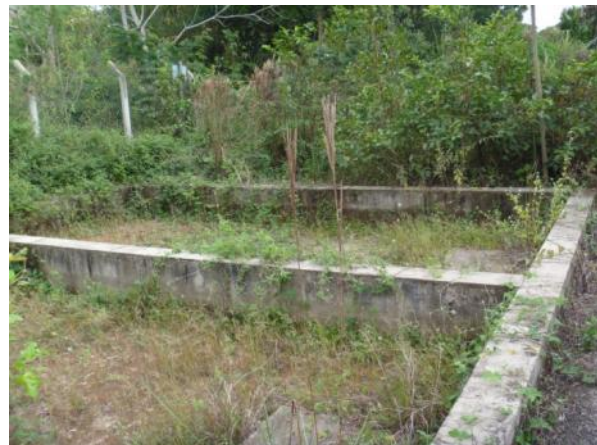
Figura 1.26 – Leito de secagem de lodo
