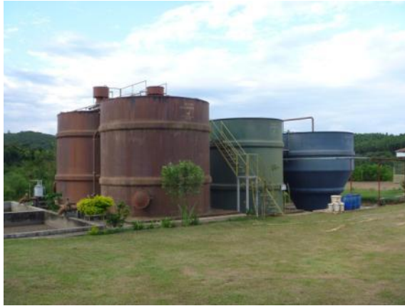
Figura 1.15 – Unidades de tratamento do esgoto da ETE sede (Reatores Aeróbios e Anaeróbios e Decantadores)
