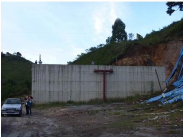
Figura 1.19 – Vista geral do reator UASB da ETE Ouro Preto
