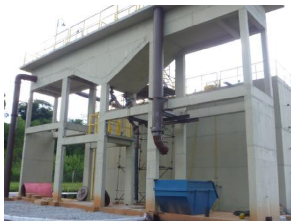
Figura 1.9 – Vista geral do tratamento preliminar
