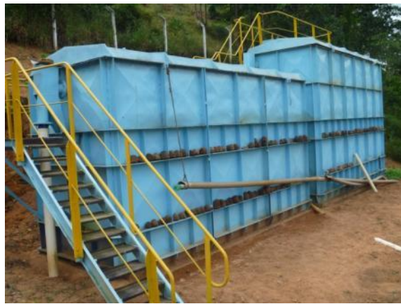
Figura 1.10 – Reator UASB e Filtro Anaeróbio
