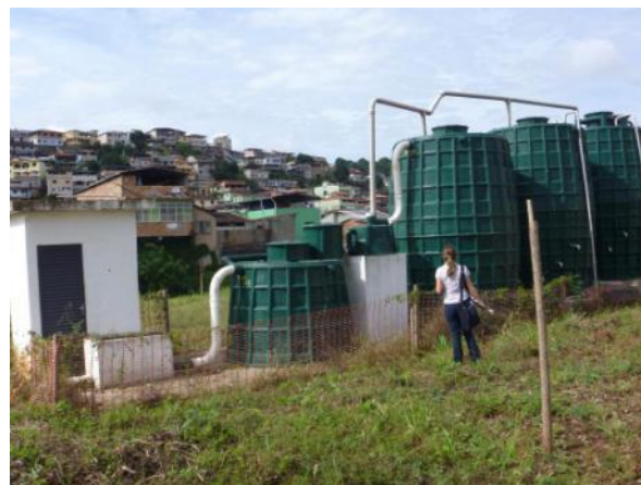
Figura 1.17 – ETE da Policlínica Municipal
