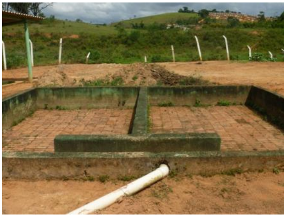
Figura 1.9 – Leitos de Secagem
