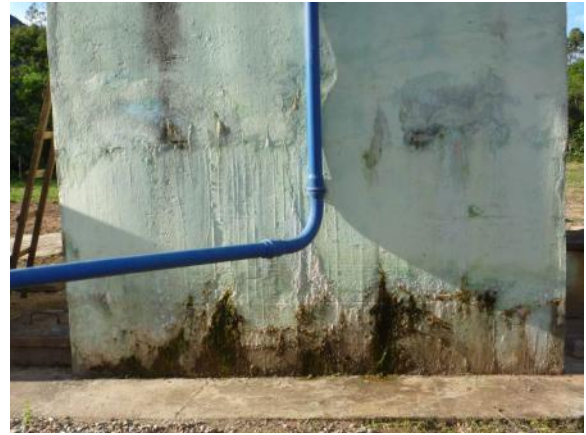
Figura 1.9 – Ocorrência de corrosão no reator UASB
