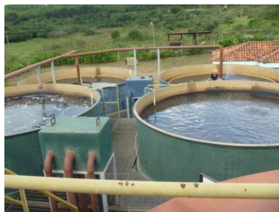
Figura 1.6 – Vista superior / Reatores aeróbios e decantadores
