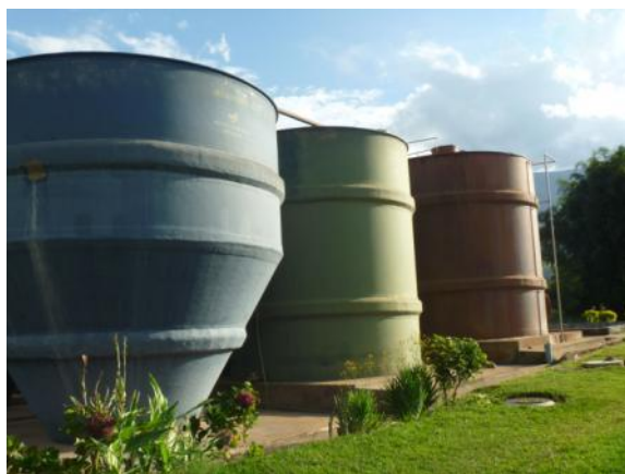
Figura 1.3 – Unidades de tratamento do esgoto da ETE sede (Reatores Aeróbios e Anaeróbios e Decantadores)
