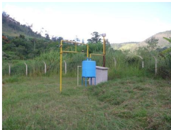
Figura 1.20 – Queimador de biogás
