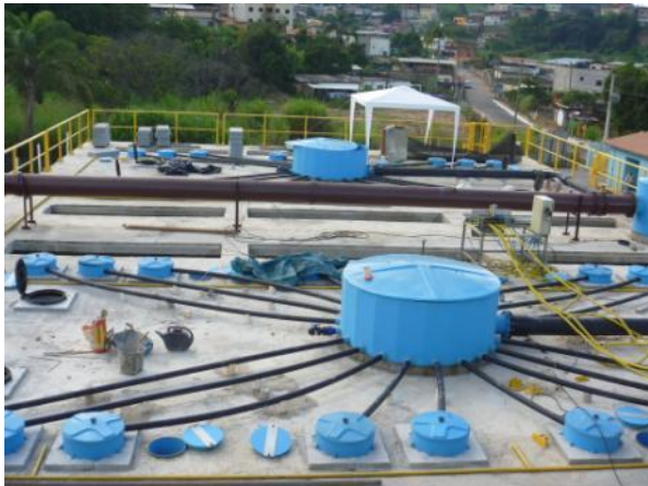
Figura 1.16 – Caixas distribuidoras de esgoto do reator UASB
