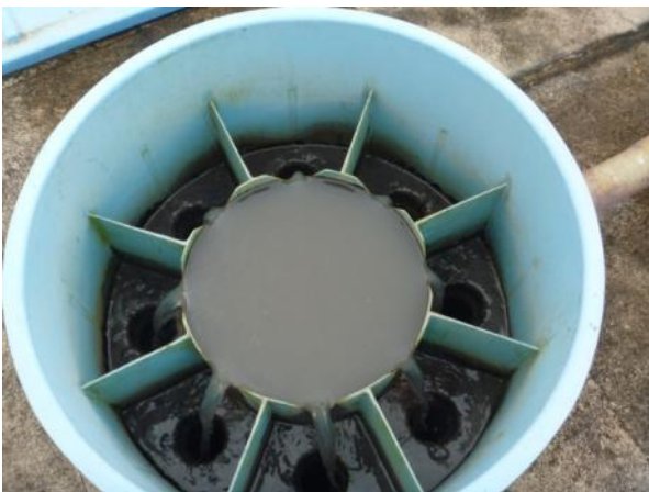
Figura 1.13 – Caixa de distribuição do reator UASB
