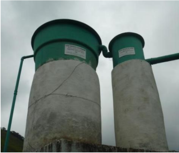
Figura 1.3 - Tratamento Preliminar ETE Severo (Caixas Gradeada, Desarenadora e Divisora de Vazão)
