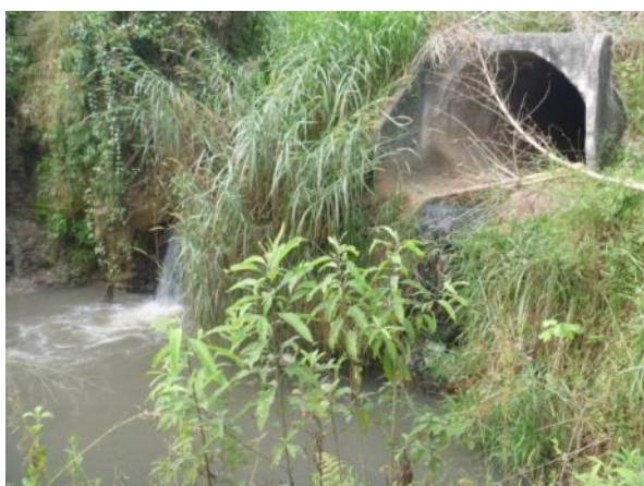
Figura 1.5 – Lançamento de esgoto bruto no córrego da Cartucha
