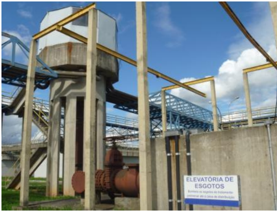
Figura 1.6 – Elevatória de esgotos
