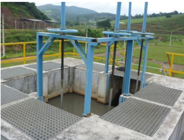
Figura 1.11 – Distribuição do esgoto para os reatores UASB
