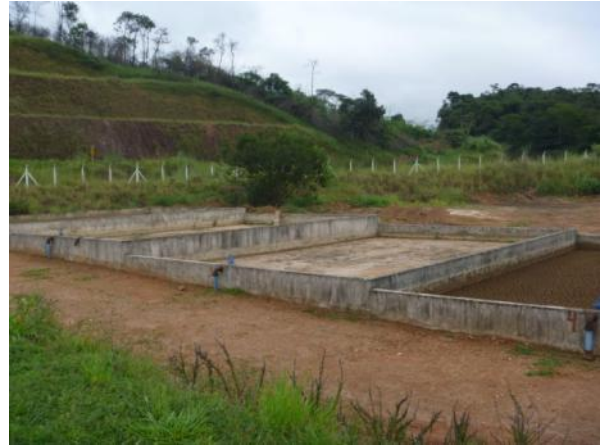
Figura 1.16 – Leitões de secagem de lodo
