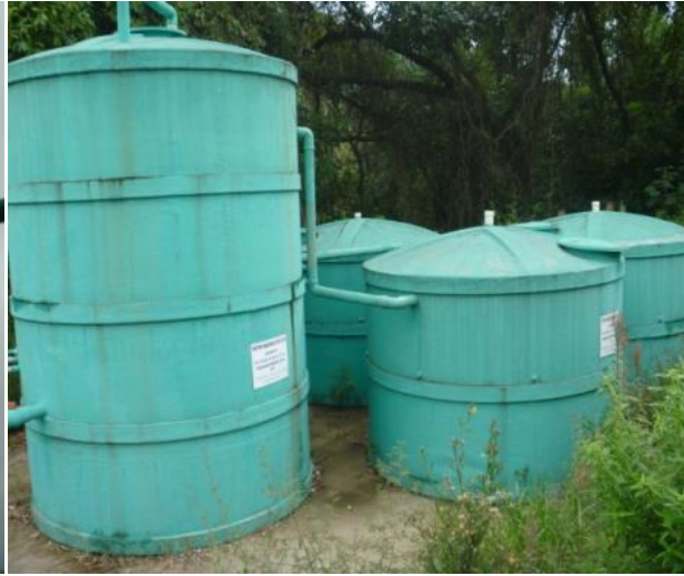
Figura 1.4 – ETE Severo / Reator UASB e Filtros Anaeróbios
