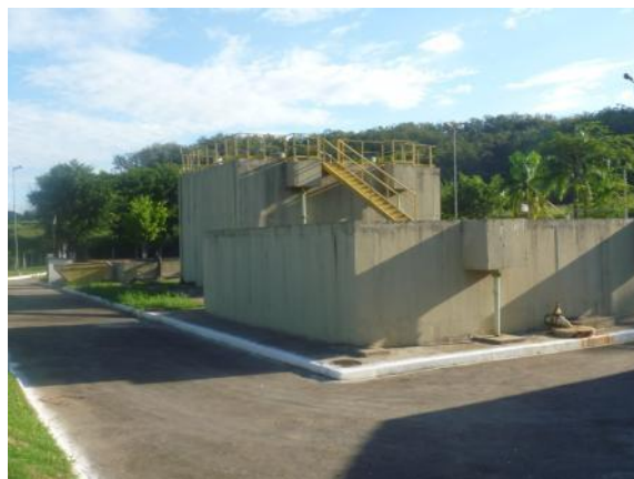
Figura 1.14 – Vista geral do reator UASB e filtro anaeróbio
