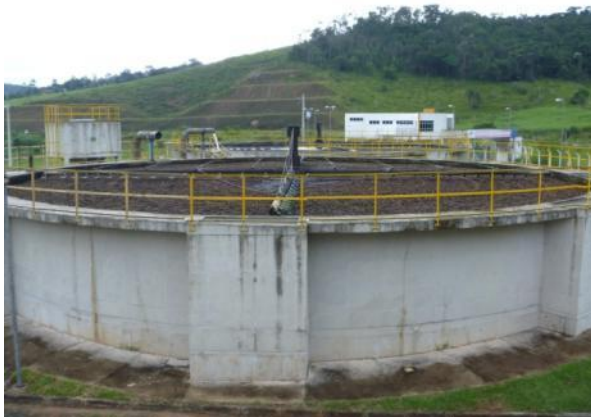
Figura 1.17 – Vista geral dos filtros biológicos percoladores
