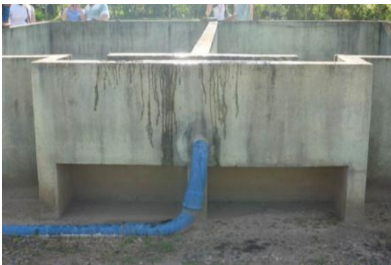
Figura 1.12 – Descarte do lodo no leito
