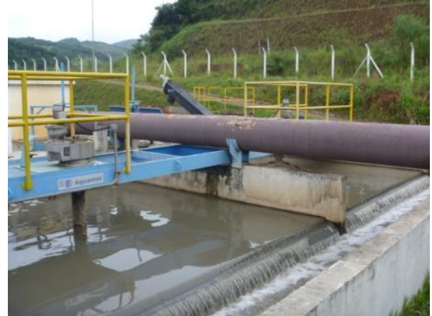
Figura 1.6 – Desarenadores com limpeza mecanizada
