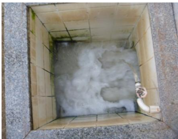
Figura 1.21 – Saída do efluente dos decantadores secundários
