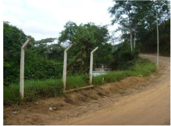
Figura 1.21 – Cercamento da ETE comprometido
