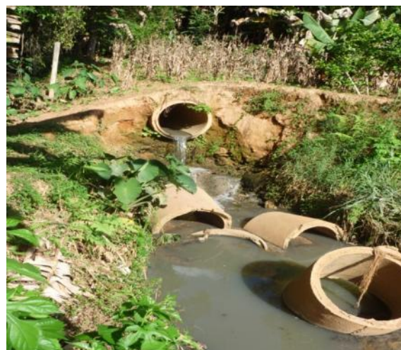
Figura 1.4 – Lançamento do esgoto in natura na sede, Rio do Peixe, afluente do Piranga
