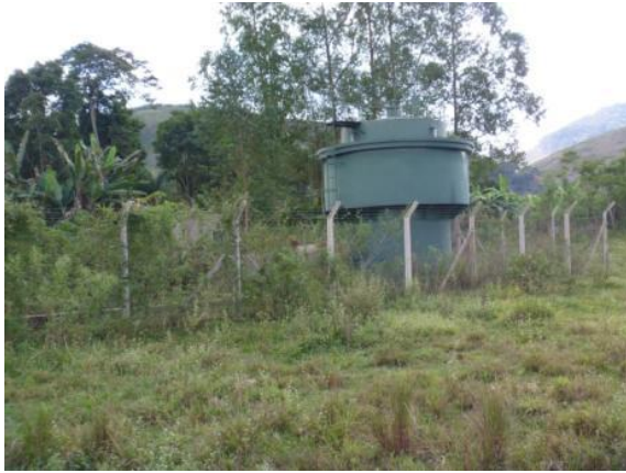
Figura 1.23 – Vista geral da ETE Águas Claras
