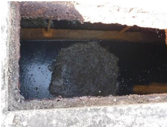
Figura 1.10 – Presença de espuma no interior do reator UASB
