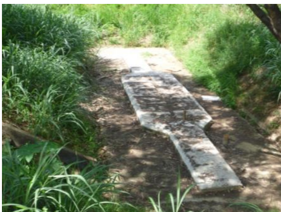
Figura 1.9 – Tratamento preliminar inoperante
