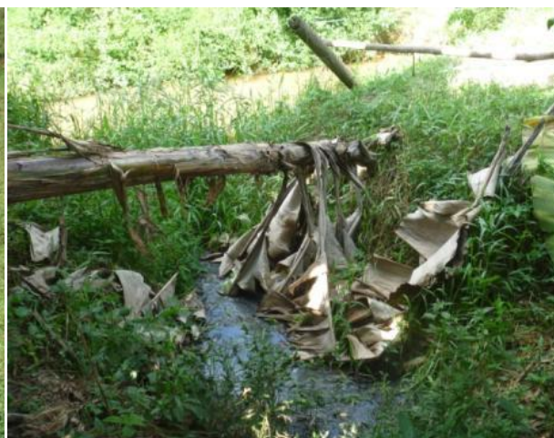
Figura 1.4 – Ponto de lançamento do esgoto in natura no córrego Belém, afluente do rio Doce, Distrito Cava Grande
