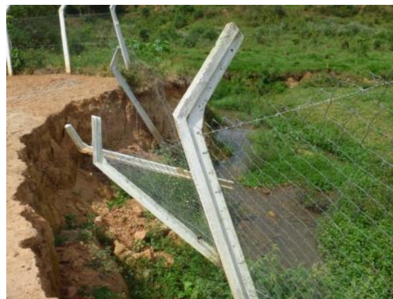
Figura 1.6 – Erosão na beira do córrego Cerâmica comprometendo o cercamento
