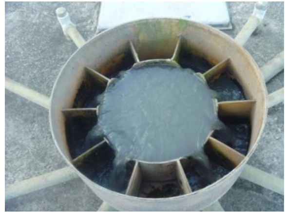
Figura 1.27 – Esgoto sendo distribuído no reator UASB
