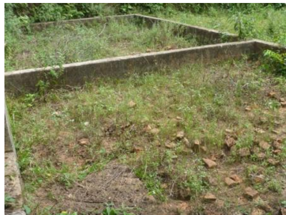
Figura 1.17 – Leitos de Secagem
