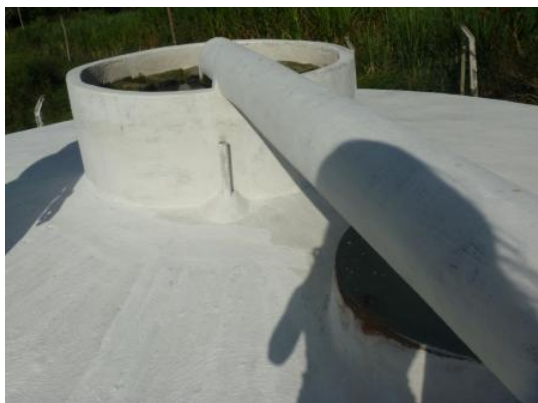
Figura 1.6 – Tubulação de saída do biogás
