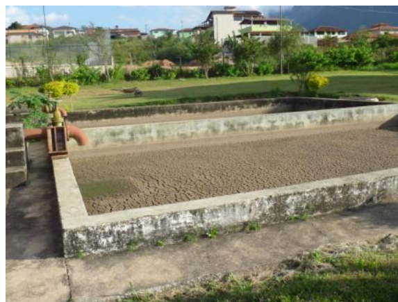
Figura 1.4 – Leitos de Secagem
