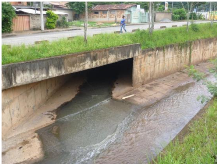
Figura 1.1 – Lançamento de esgoto bruto no córrego São Bento
