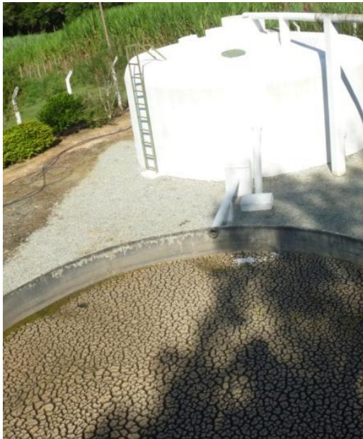
Figura 1.4 – Descarte do lodo excedente no leito de secagem
