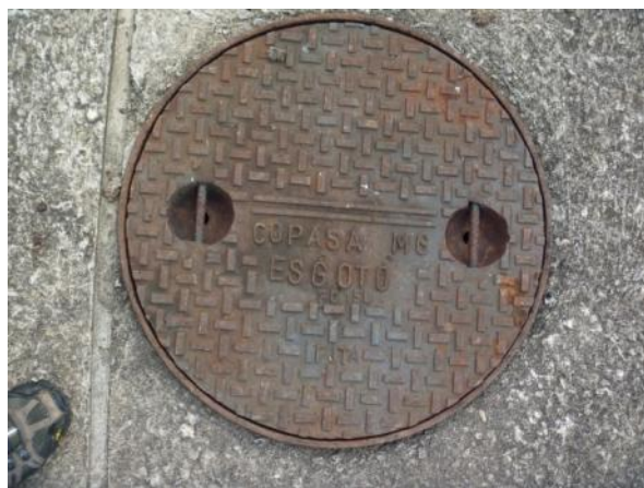
Figura 1.21 – Tampa do poço de visita da ETE Furquim
