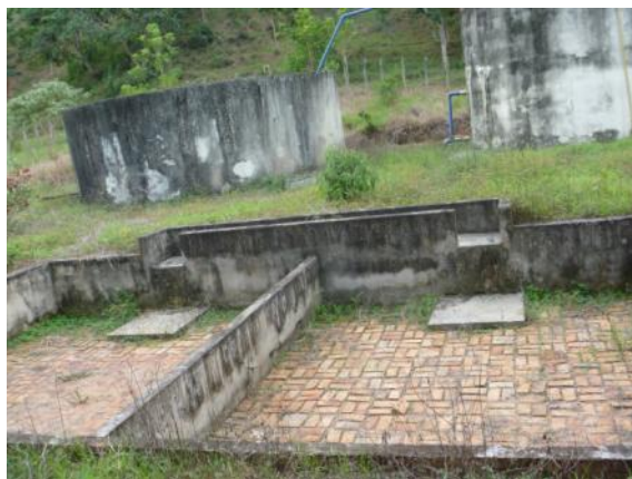
Figura 1.12 – Leitos de Secagem
