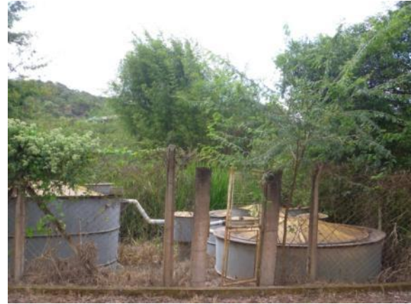
Figura 1.43 – Portão de acesso depredado
