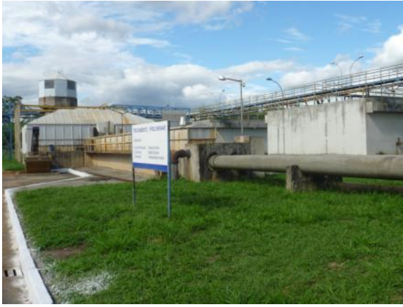
Figura 1.4 – Vista geral do tratamento preliminar
