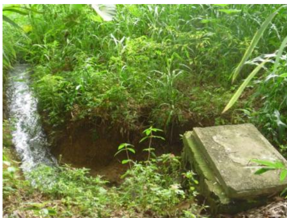
Figura 1.3 – Lançamento do esgoto in natura no distrito de Teixeiras
