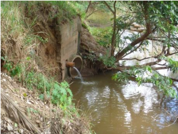
Figura 1.1 – Lançamento de esgoto bruto no rio Piracicaba
