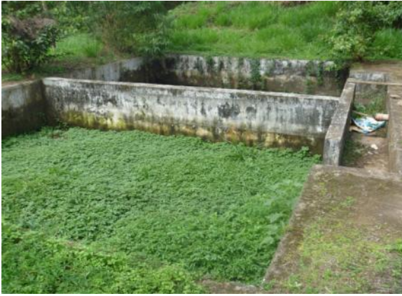
Figura 1.27 – Leitos de Secagem
