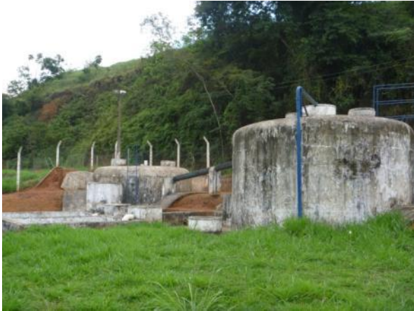
Figura 1.6 – Vista geral da ETE Santa Maria
