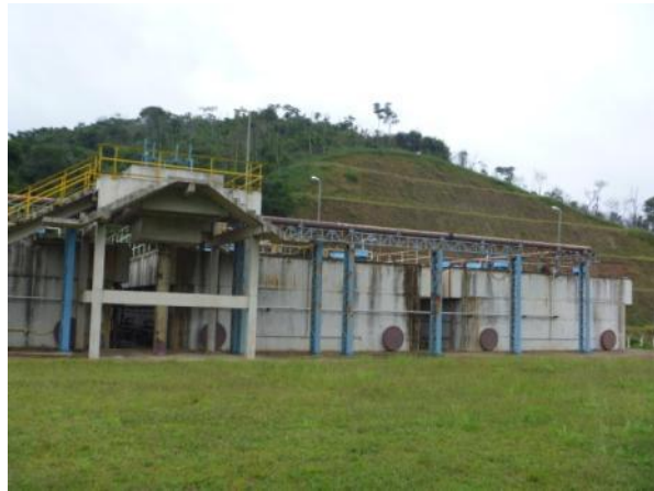
Figura 1.10 – Vista geral dos reatores UASB
