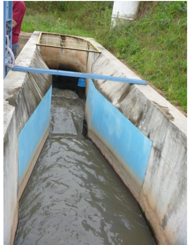
Figura 1.8 – Calha Parshall com medidor eletrônico de vazão
