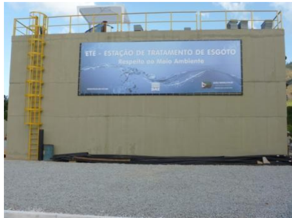
Figura 1.15 – Presença de guarda corpo metálico no reator UASB
