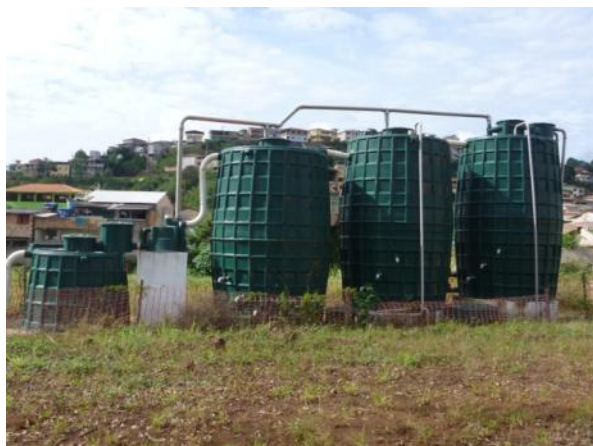
Figura 1.16 – ETE da Policlínica Municipal
