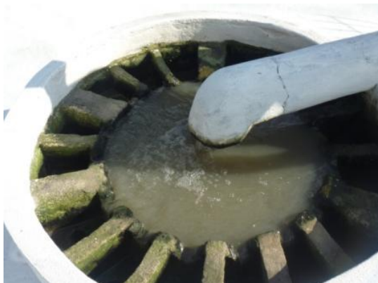
Figura 1.7 – Caixa de distribuição do esgoto
