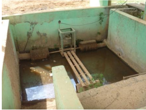
Figura 1.8 – Tratamento preliminar – Desarenador
