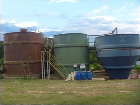
Figura 1.9 – Unidades de tratamento do esgoto da ETE sede (Reatores Aeróbios e Anaeróbios e Decantadores)
