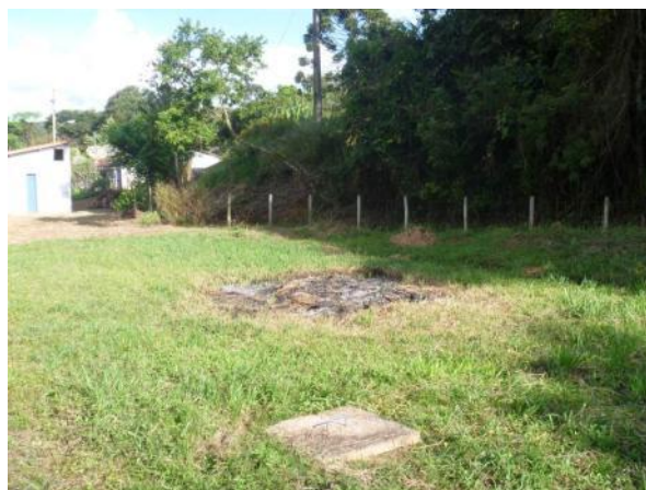
Figura 1.18 – Vestígios de queima de material na ETE São Bartolomeu
