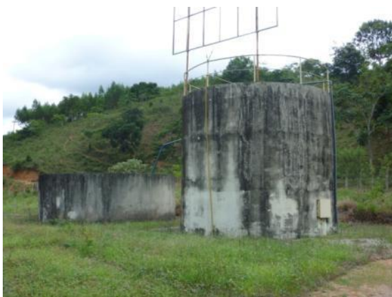
Figura 1.10 – Reator UASB e Filtro Anaeróbio
