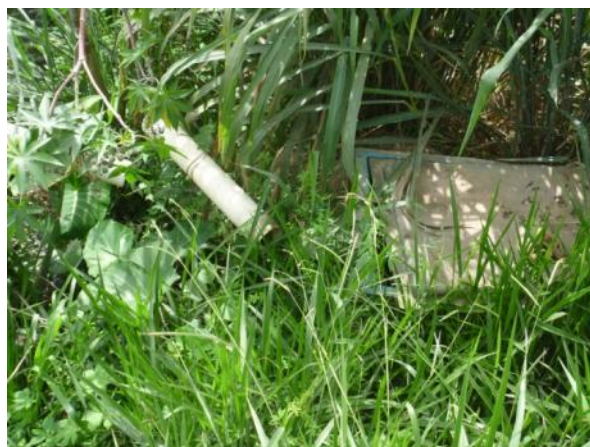
Figura 1.25 – Tubulação rompida na ETE 1 – Cidade Nova
