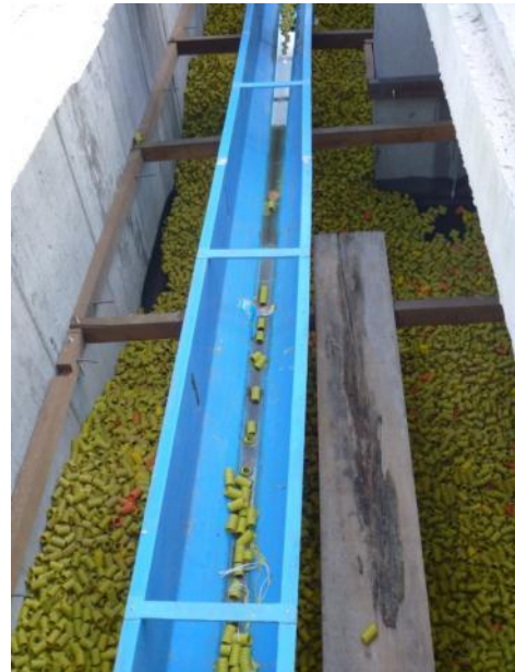
Figura 1.17 – Interior do filtro anaeróbio preenchido com eletrodutos
