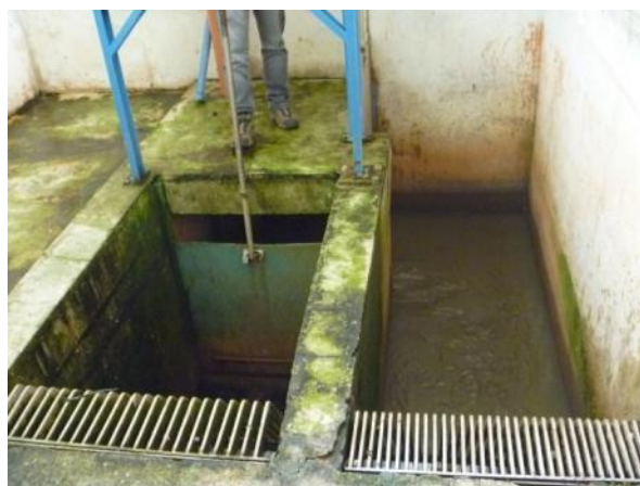
Figura 1.4 – Primeiras grades do tratamento
