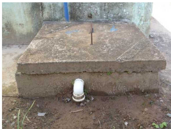
Figura 1.15 – Indícios de infiltração de esgoto no solo
