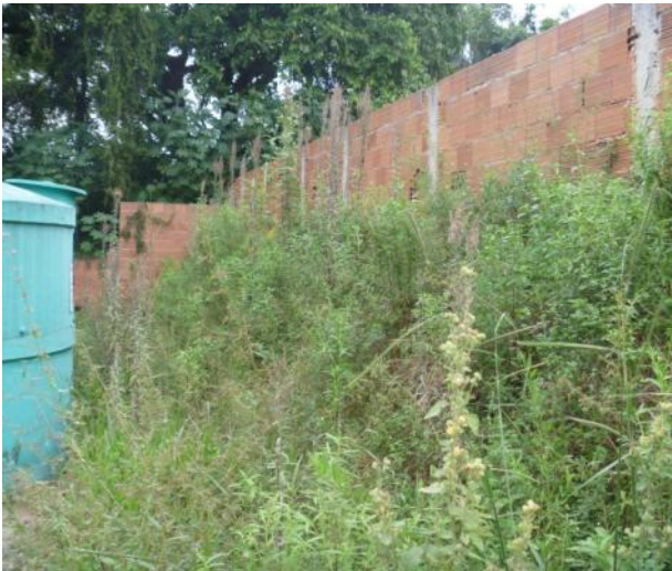
Figura 1.5 - ETE Severo/Paisagismo inadequado
