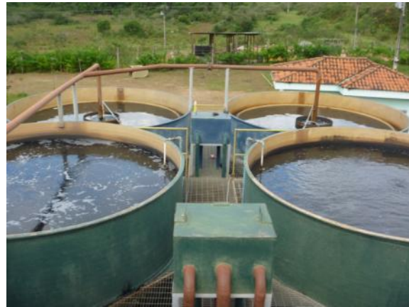
Figura 1.22 – Reatores aeróbios e Decantadores
