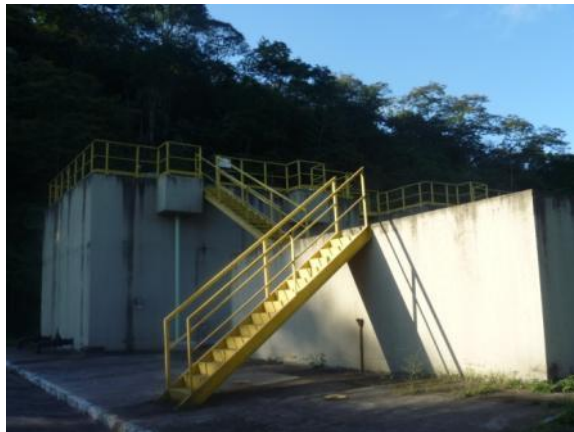
Figura 1.23 – Vista geral reator UASB e filtro anaeróbio
