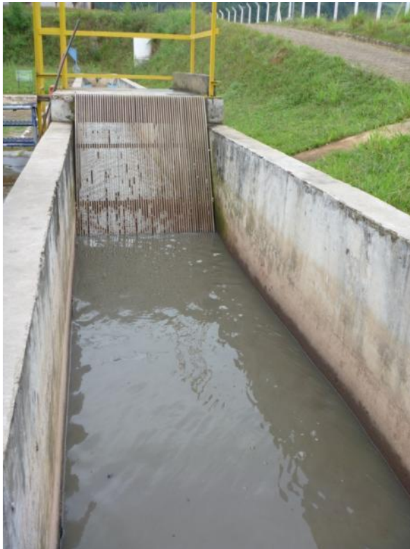
Figura 1.7 – Segunda grade do tratamento preliminar
