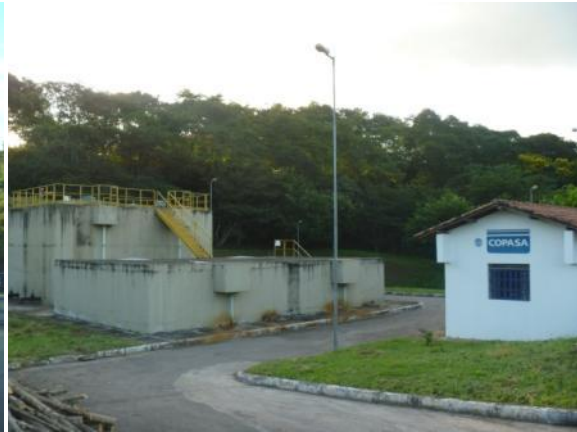
de Figura 1.34 – Vista geral do reator UASB, filtro anaeróbio e casa de apoio
